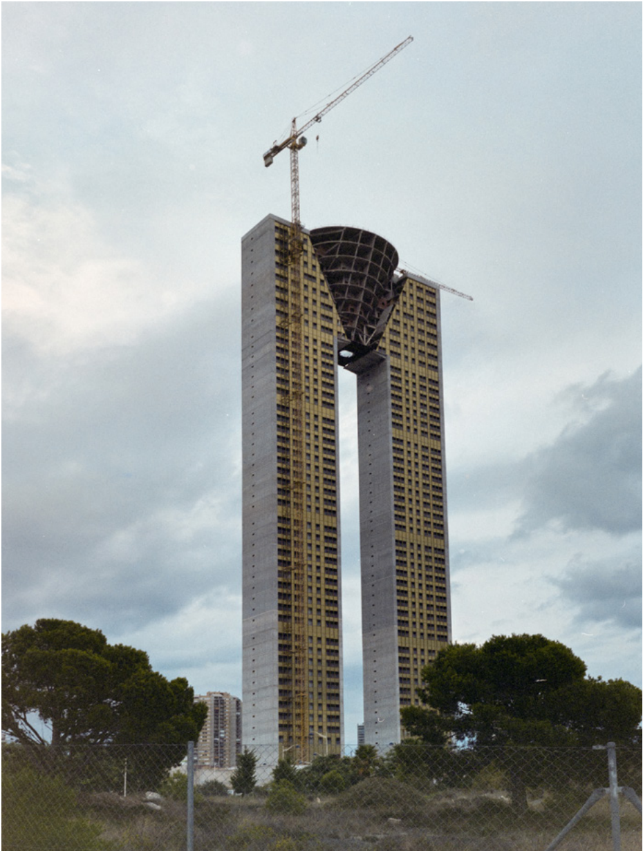
Intempo dorrea Benidormen eraikitzen Torre Intempo en Benidorm en construcción Intempo Tower in Benidorm under construction © Mikel Eskauriaza
